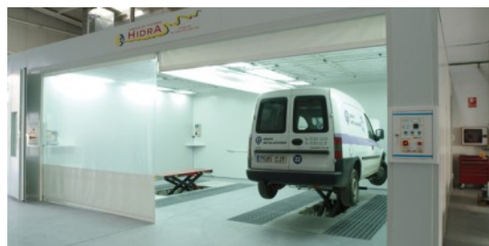
ÁREA DE PREPARAÇÃO PARA PINTURA
