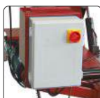
Caixa de controlo de 24V
